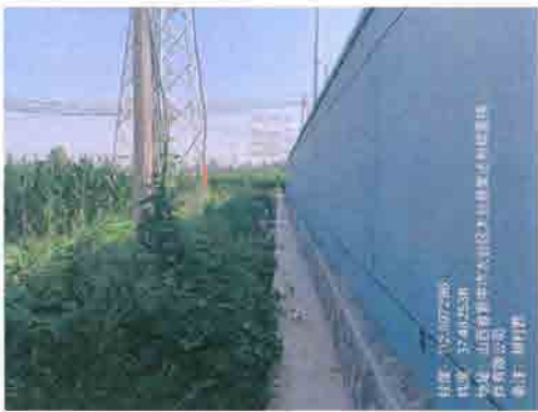
胡村变电站西侧
