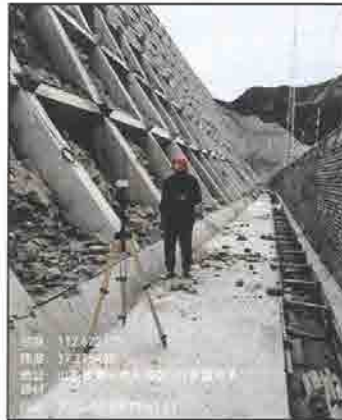
升压站东南侧电磁场监测
