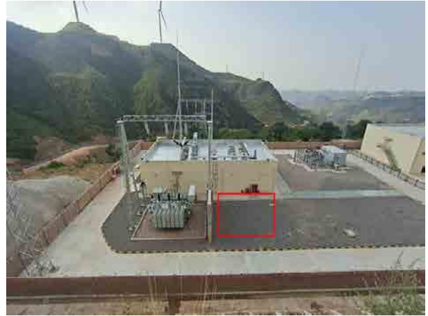
100MVA 主变安装位置
