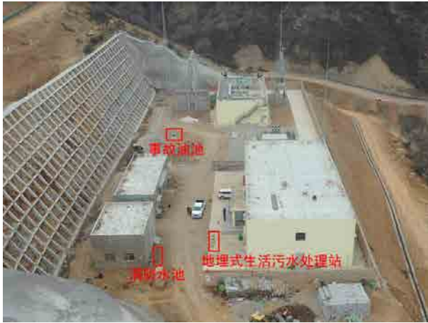
阳邑 110kV 升压站
