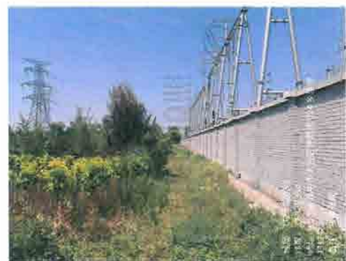
贯家堡变电站南侧
