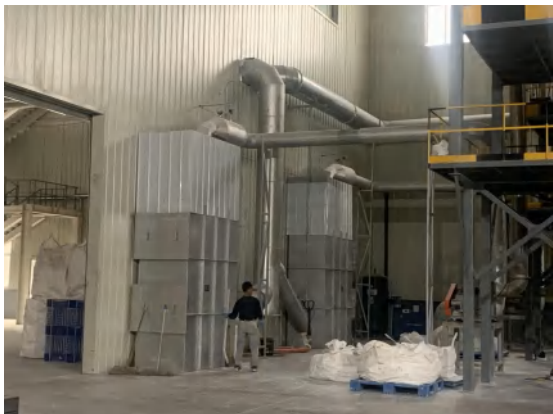
已建回转炉的脱硝装置
