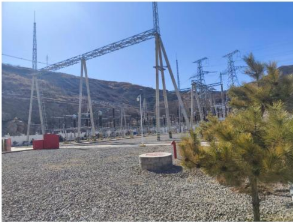
二期主变位置
