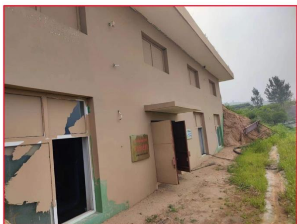
生活污水处理站
