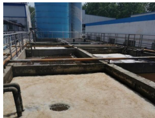
现有污水处理站
