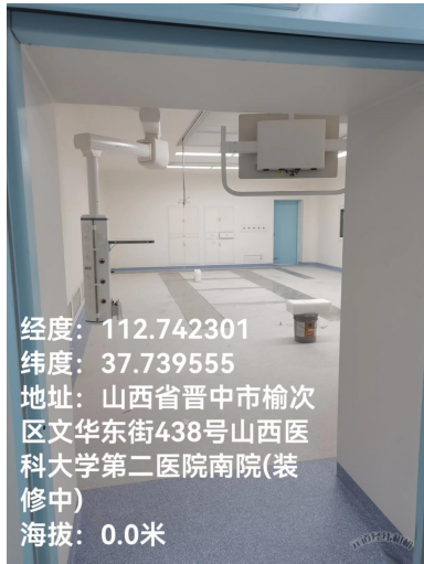
医技楼杂交手术室
