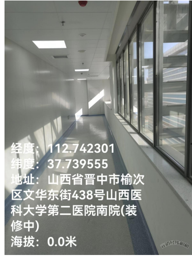
杂交手术室南侧走廊
