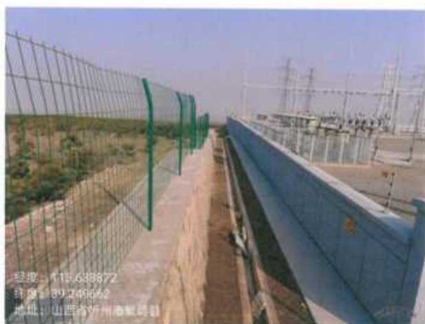
溇源 220kV 变电站西侧
