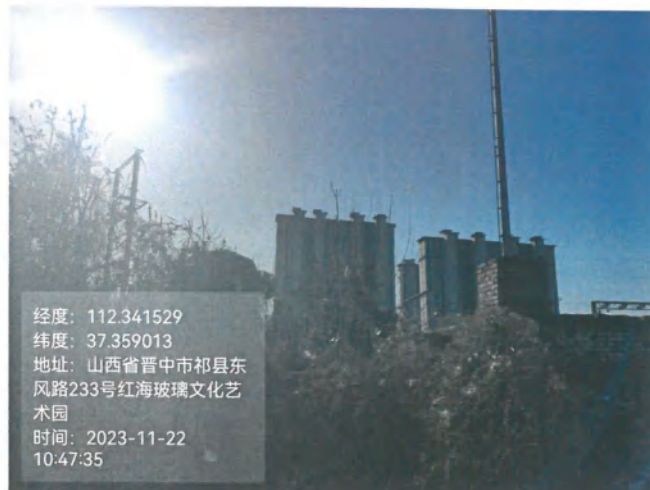
祁县 110kV 变电站东侧
