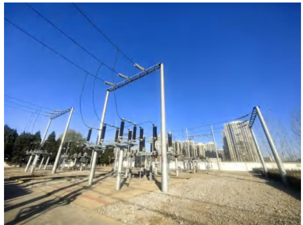
110kV 配电装置
