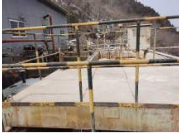
荡荡岭生活污水处理站
