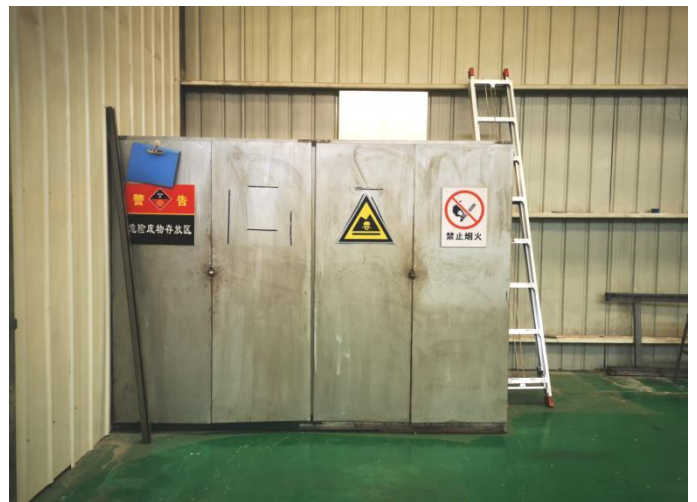
厂区现有危废暂存间
