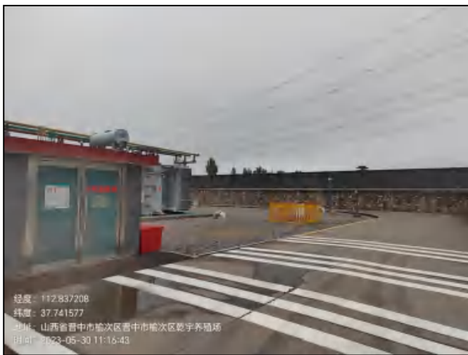
现有事故油池
