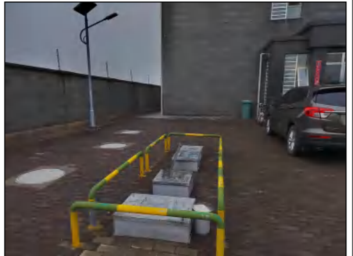
一体化污水处理装置
