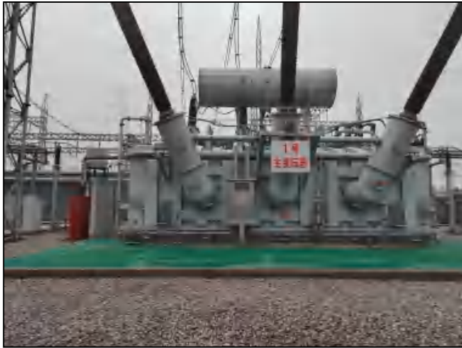
福瑞 500kV 变电站内主变
