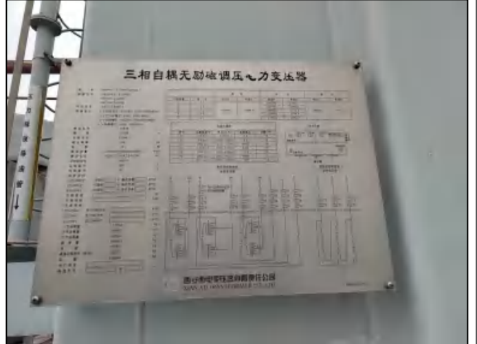
福瑞 500kV 变电站主变铭牌（油重 151.4t）
