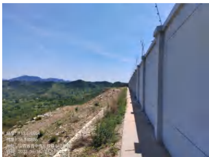
羊角风电 110kV 升压站东侧
