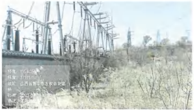
辽阳 220kV 变电站东北侧
