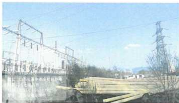
左权 110kV 变电站南侧
