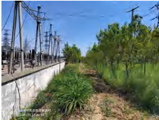
漳河 110kV 变电站东侧
