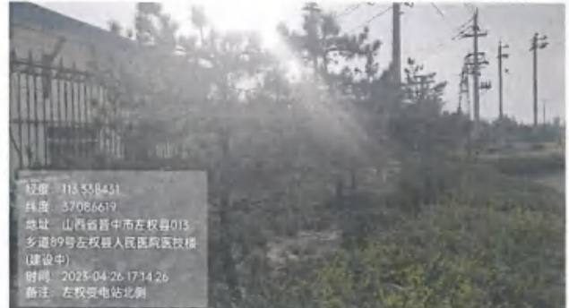
左权 110kV 变电站北侧
