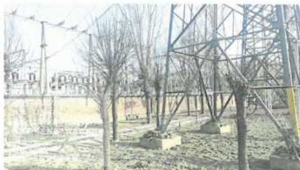
左权 110kV 变电站西侧
