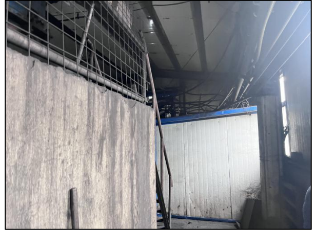
主斜井皮带控制室
