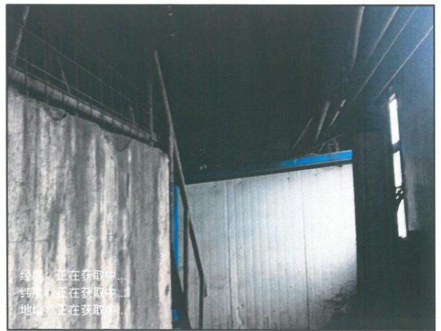
主斜井皮带控制室
