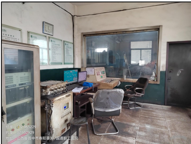
主斜井井口房内二层操作室
