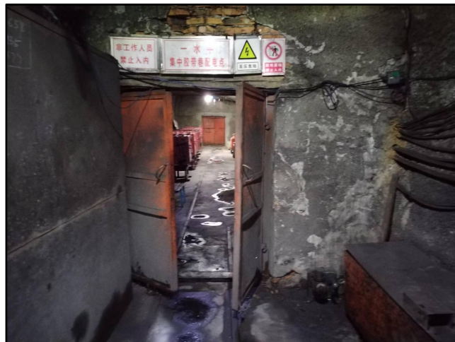
井下一水平无损检测装置操作室及配电室
