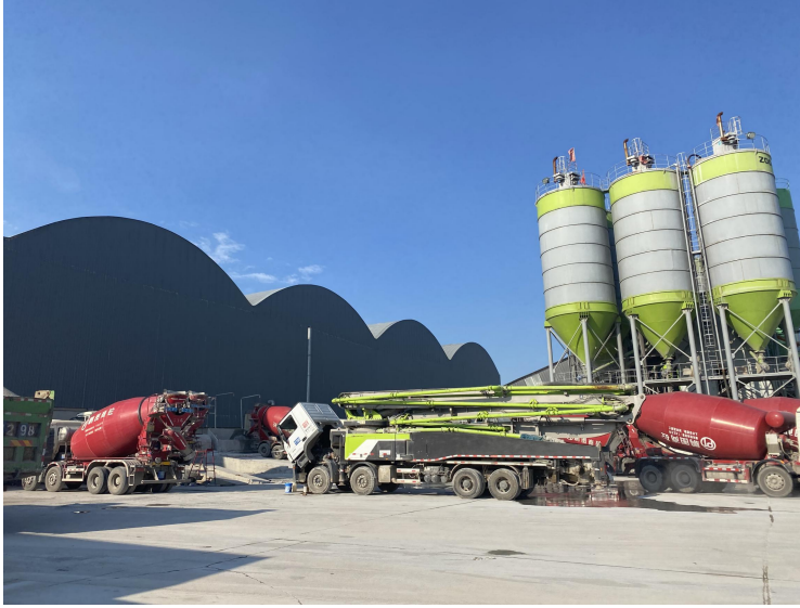
现有混凝土搅拌站
