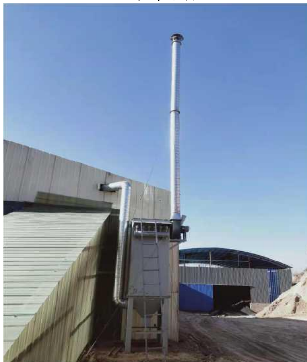
破碎车间 15m 排气筒
