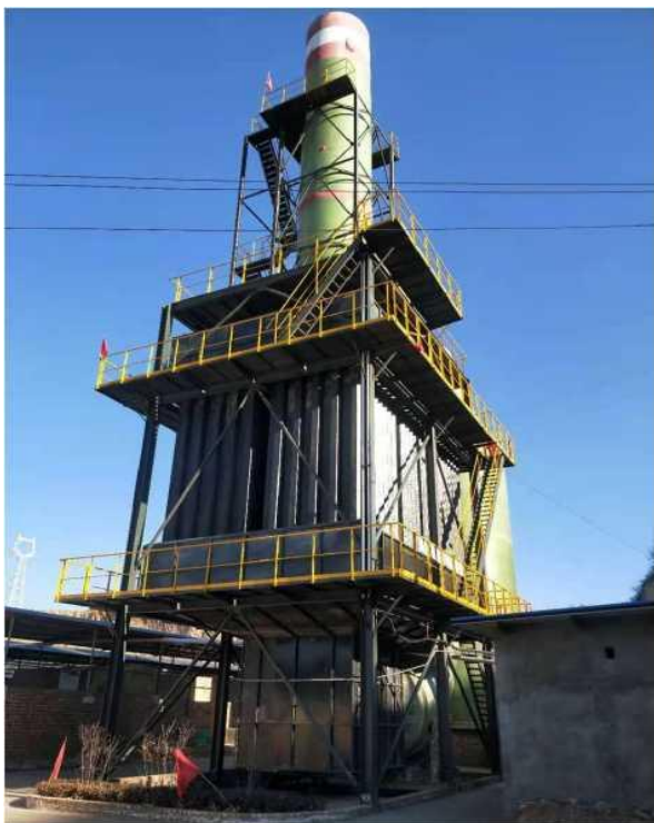
原有工程脱硫、静电除尘设备
