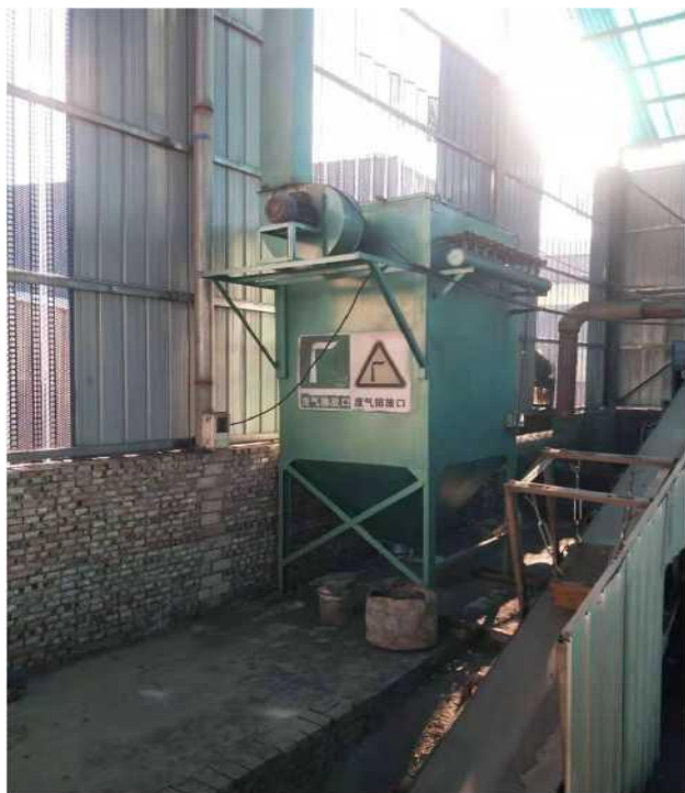
粘土筛分车间布袋除尘器
